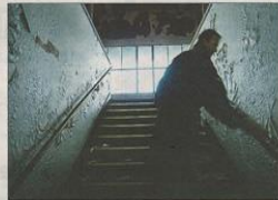
Flisser av. John Brendmoe studerer malingen på vegg i trappen opp til annen etasje.
